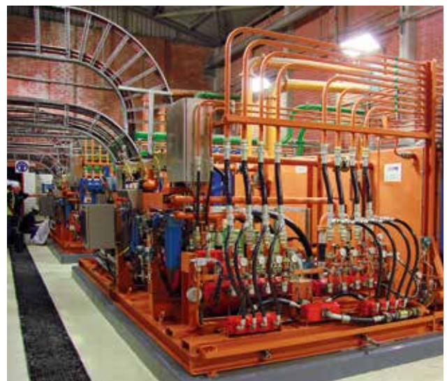
Zentralschmieranlage mit GHM-Honsberg Volumenstrom-Messgeräten, Drucksensoren und Temperatursensoren
