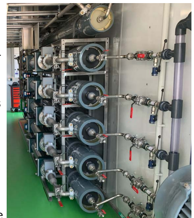
Blick in den Container auf die halbdurchlässigen Membranen der Umkehrosmose-Anlagen
